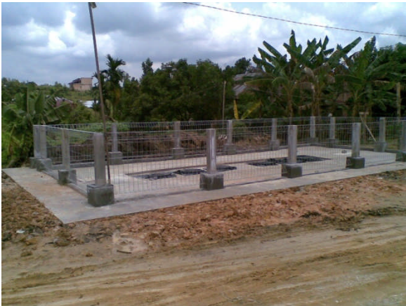
Foto 4.19. PS Air Limbah RSH Kws Kota Pekanbaru Tenaya Raya (Riau)
